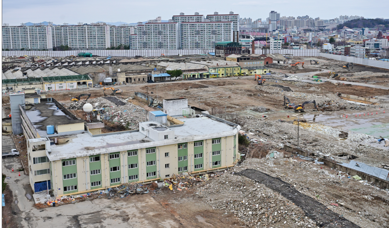
광주 북구 임동 옛 전방일산방직 부지내에 들어서는 더현대 광주와 4300여세대 규모의 아파트를 짓기 위한 철거 작업이 한창이다. 최기남 기자 bluesky@gwangnam.co.kr
