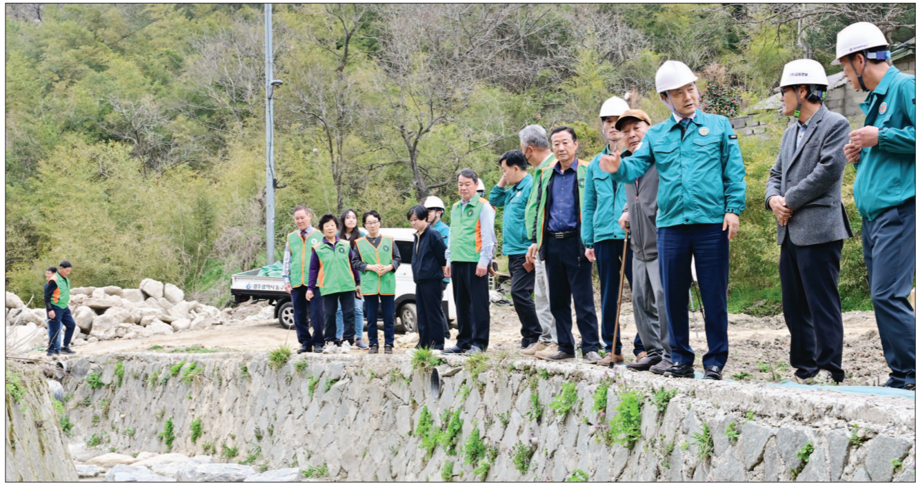
동구, 공공시설 정비공사 현장방문 27일 광주 동구 월남동 주민미를 세친 정비공사 현장을 방문한 인택 동구청장이 공사 추진사항 및 안전점검을 살펴보고 있다. 최기남 기자 bluesky@gwangnam.co.kr
