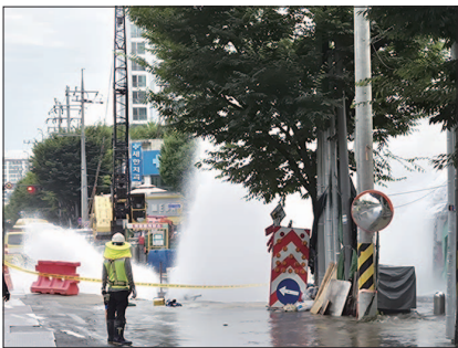
31일 오전 금호동 도시철도 공사현장 상수도관이 파열돼 9000여t의 수돗물이 분출했다.
