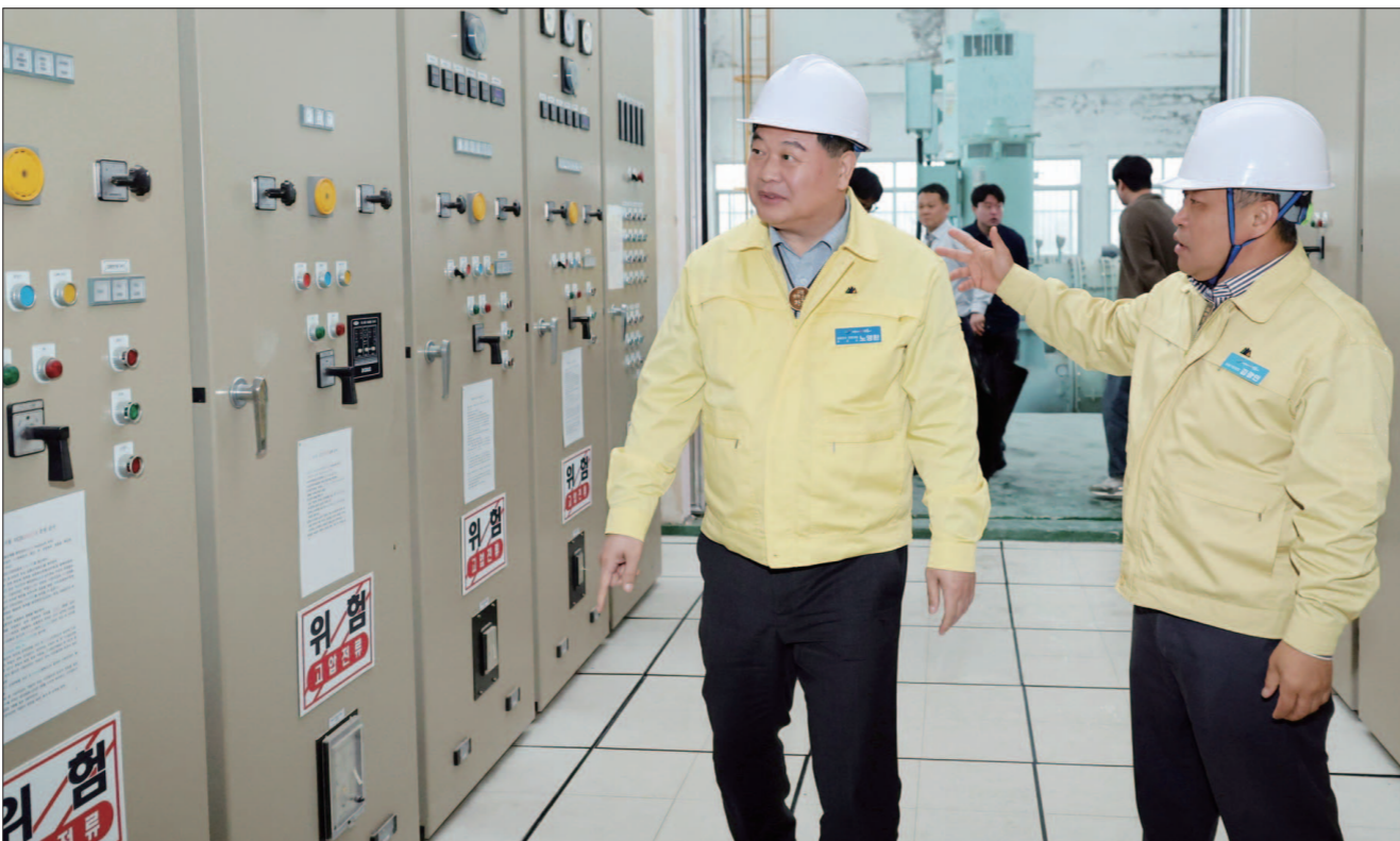
노영환 장흥군수 권한대행은 최근 배수펌프장 현장을 직접 방문해 펌프 작동 상태와 제어실비 정상 여부, 비상발전기 관리 상태, 배수로 정비 상황 등 주요 시설 전반에 대해 집중 점검을 실시했다. 사진제공=장흥군청
